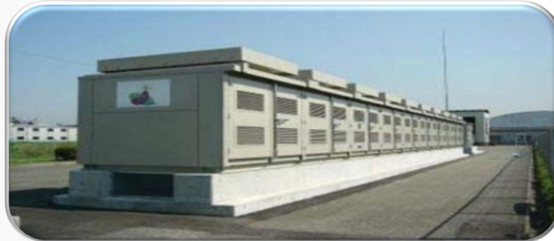
Аккумуляторные батареи большой энергоёмкости (АББЭ)
