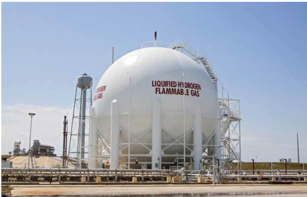
Шаровые резервуары для хранения газов
