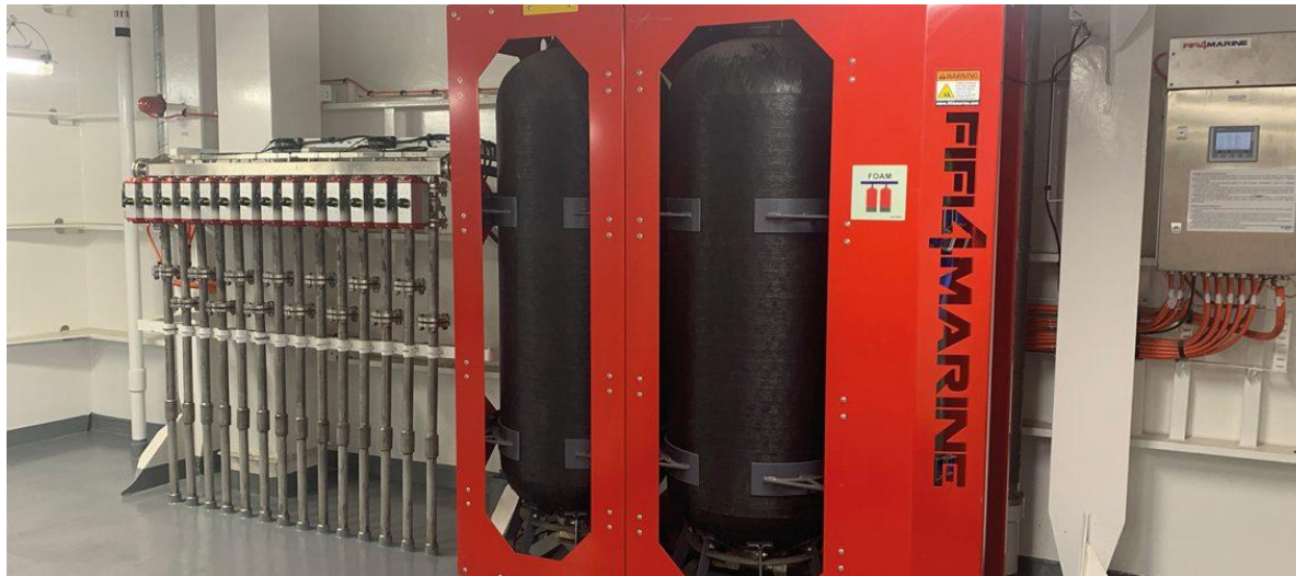
Система пожаротушения фирмы FIFI4Marine
