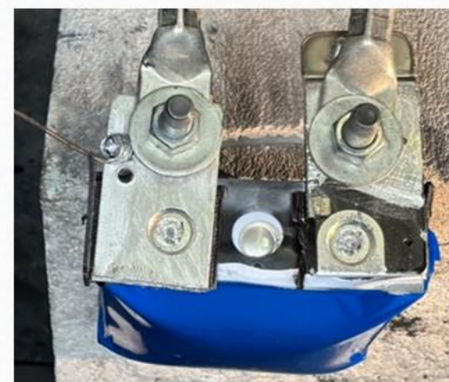
Вздутие корпуса аккумуляторной ячейки (короткое замыкание)
